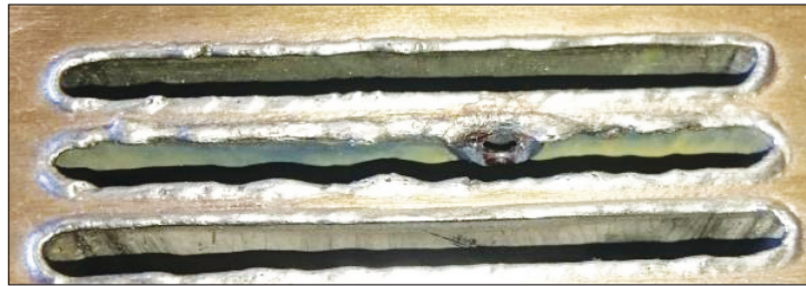
Рис. 7. Прожог стенки трубки в результате сварки в несколько проходов
