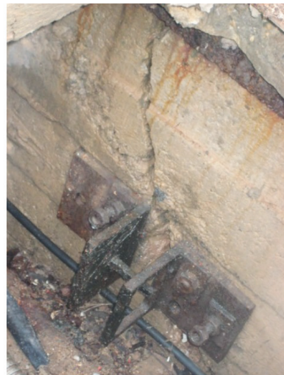
Рис. 8. Трещина с установленным на ней щелемером
