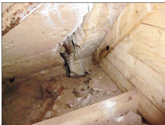
Рис. 1. Трещина в монолитном бетоне левобережного устоя нижней головы
