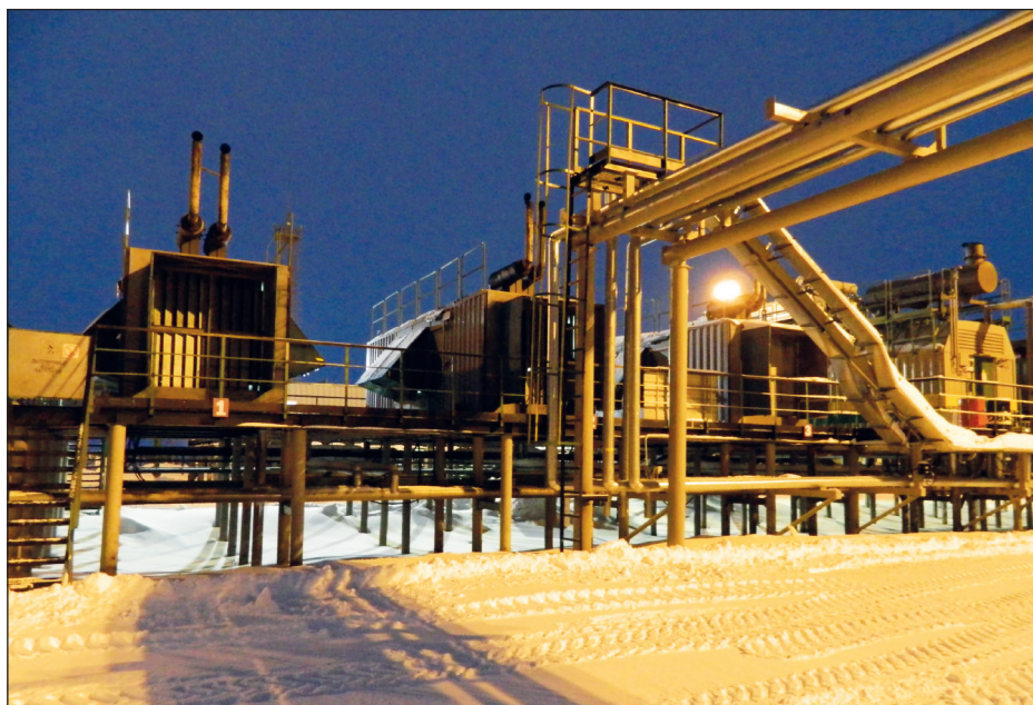
Рис. 1. Энергоцентр пункта сдачи-приемки нефти «Мусюршор»
