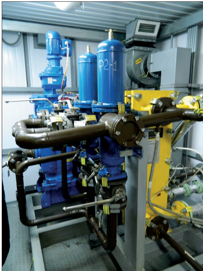
Рис. 4. Размещение механизмов в контейнере установки подготовки нефти
