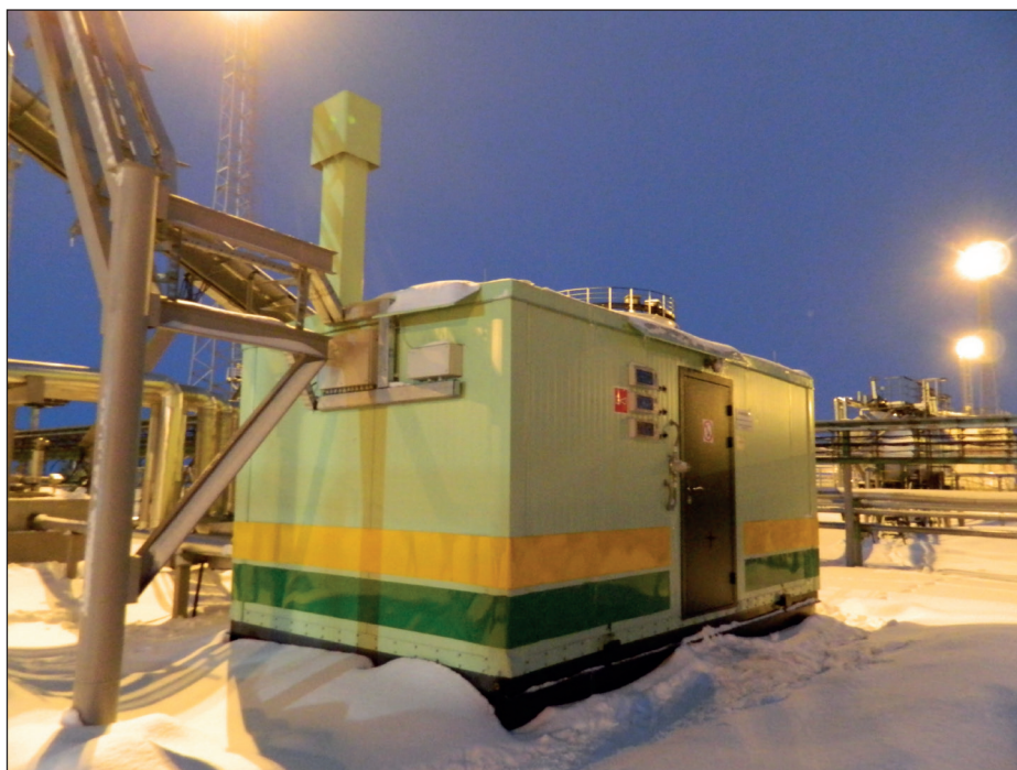
Рис. 3. Установка подготовки нефти, размещенная в контейнере
