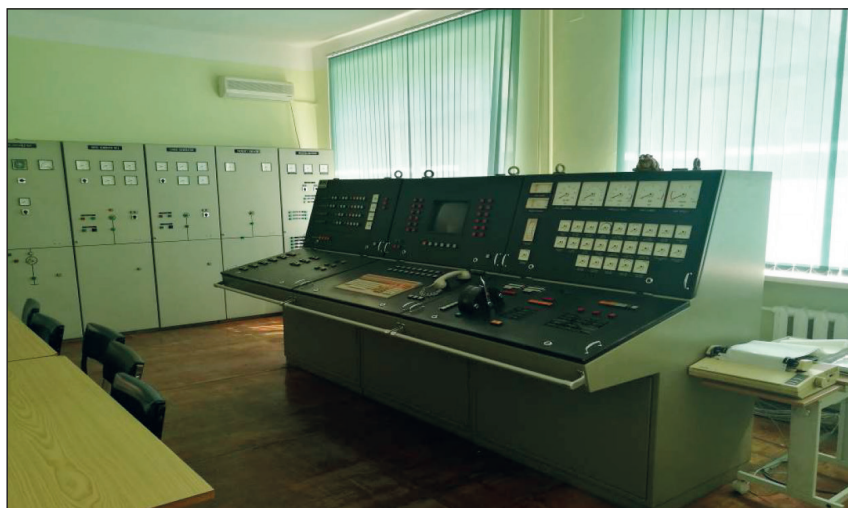
Рис. 2. Пост управления тренажёра типа «DPS 100-GFCA»
