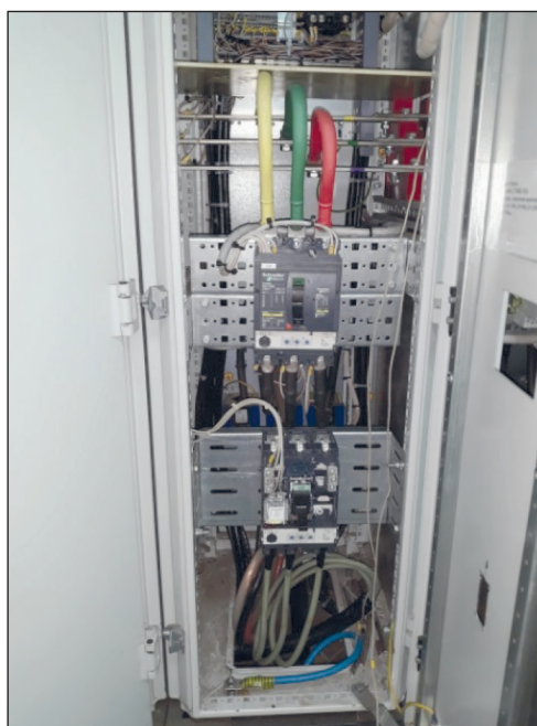
Рис. 5. Секция вентильного ДГ в составе ГРЩ
