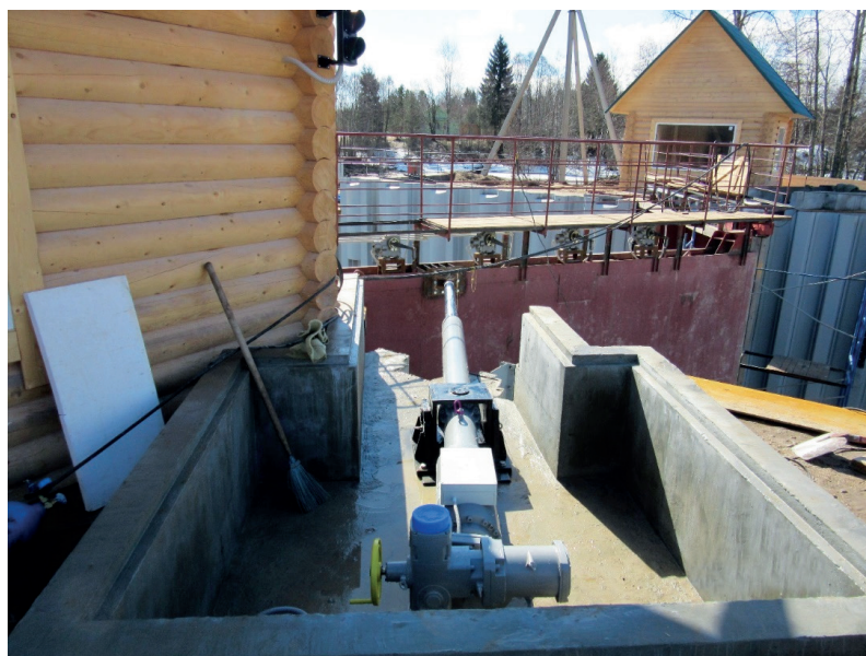
Рис. 3. Пример установки электромеханического привода типа электроцилиндр шлюза № 5 Северо-Двинской шлюзованной системы
