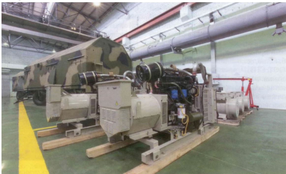
Рис. 2. Мобильные электростанции для электроснабжения объектов морской инфраструктуры
