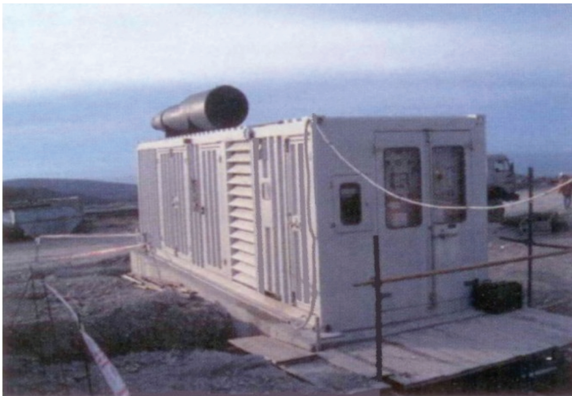
Рис. 3. Резервное электроснабжение объекта на базе дизель-генераторных установок в модульном контейнерном исполнении
