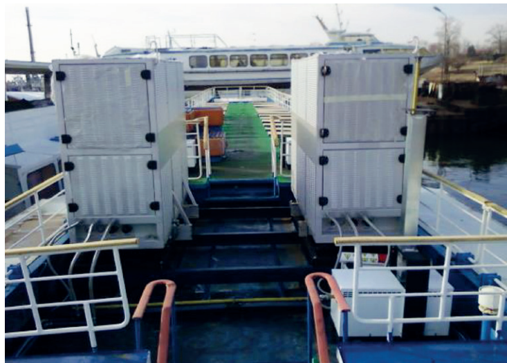
Рис. 6. Быстросъемные криогенные модули СПГ, установленные на фундаменте из металлических двутавровых балок (верхняя палуба теплохода «Нева-6»)
