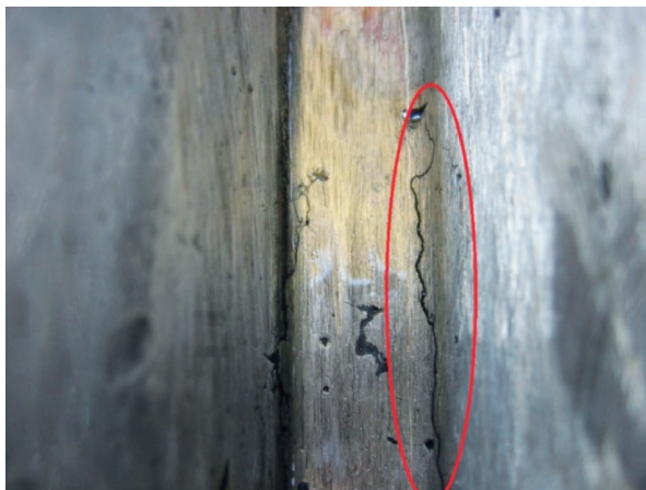
Рис. 1. Развитие усталостной трещины вдоль зуба колеса открытой передачи
